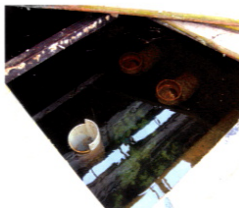
タタキ池の水は、一度この沈澱槽を経由してろ過槽へと送られて行く
